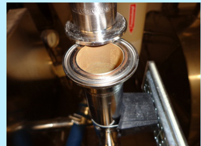
Rouging dans le tuyau en acier inoxydable d'une conduite
